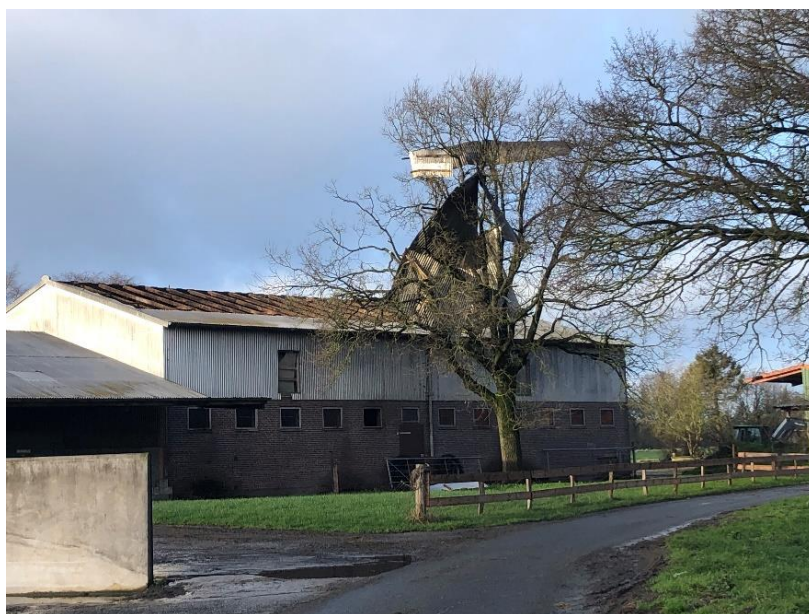
Auswirkungen von „Goran“: Ebenfalls von einer Sturmböe wurden im Landkreis Wittmund am 21.01.2021 Teile eines Daches angehoben und weggeweht („Vorsorglich fing ein Baum das Stalldach auf.“)
