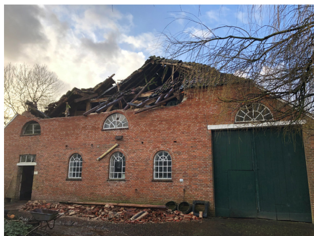
Auswirkungen von ‚Sabine‘: Von einer Sturmböe wurde ein Teil des Gulphof-Daches im Landkreis Wittmund angehoben und Teile des Mauerwerkes mit heruntergerissen
